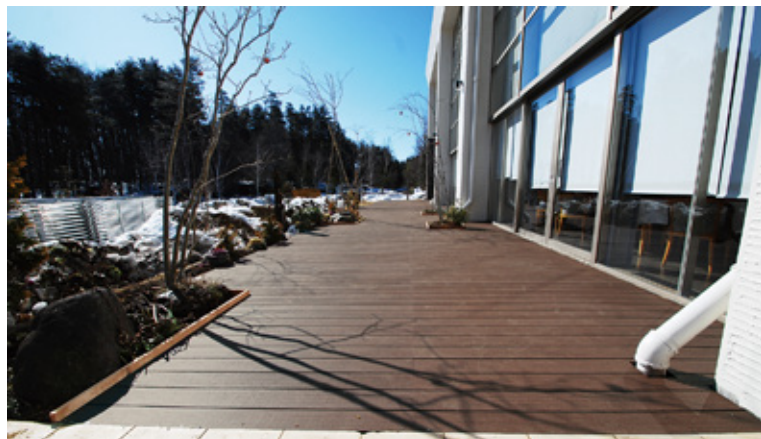
東京都新宿区からご依頼頂きました。広々とした床部分には中空デッキ材 (p.26) のライトブラウンカラーを使用しています。
